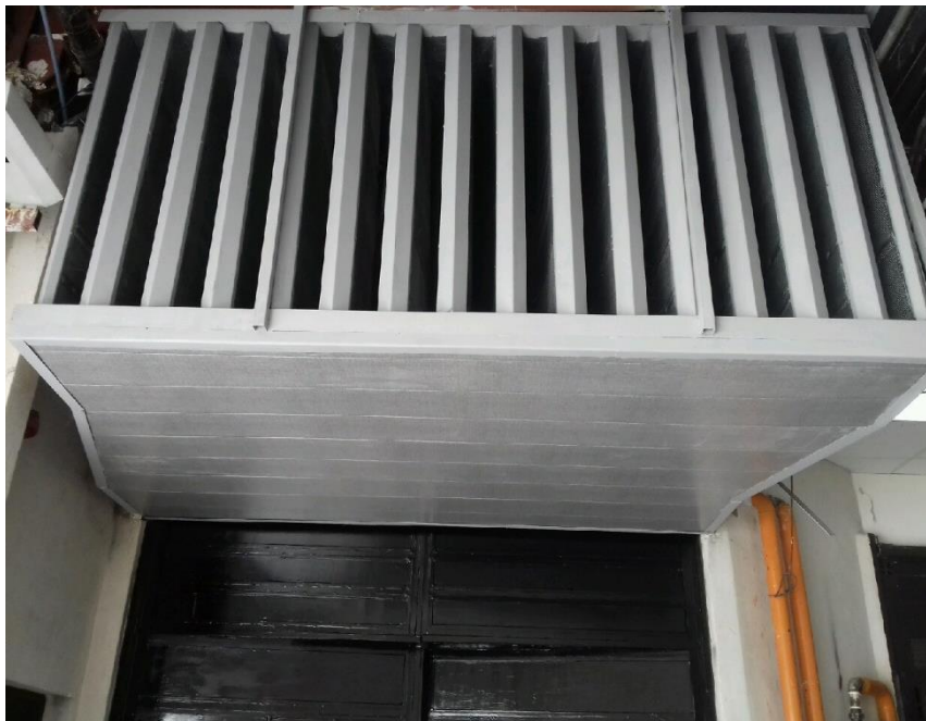
عکس‌های پنل آکوستیک و سایلنسر تهویه اتاق CHP توزیع برق مشهد
